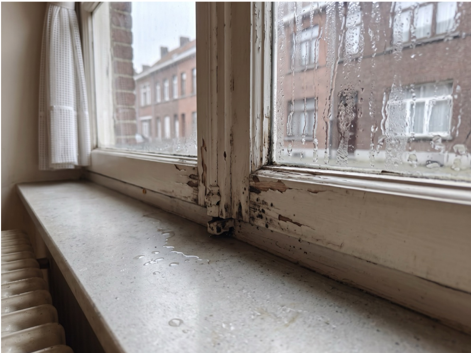
Condensation et moisissures
